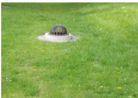
Figur 11: Tillfällig översvämningsyta med upphöjd kuppelbrunn
